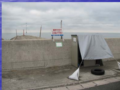
簡易局舎設置状況
