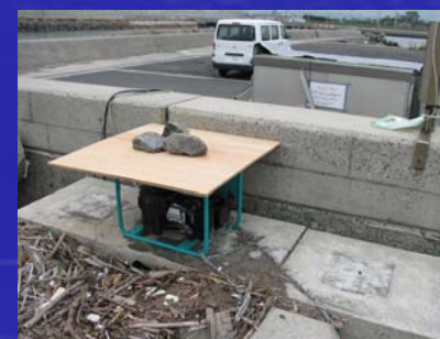
発電機配置状況
