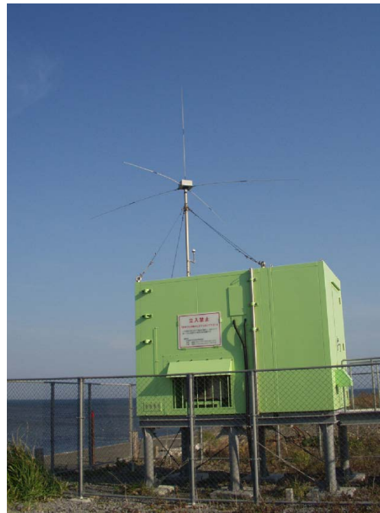
受信アンテナとシェルター
