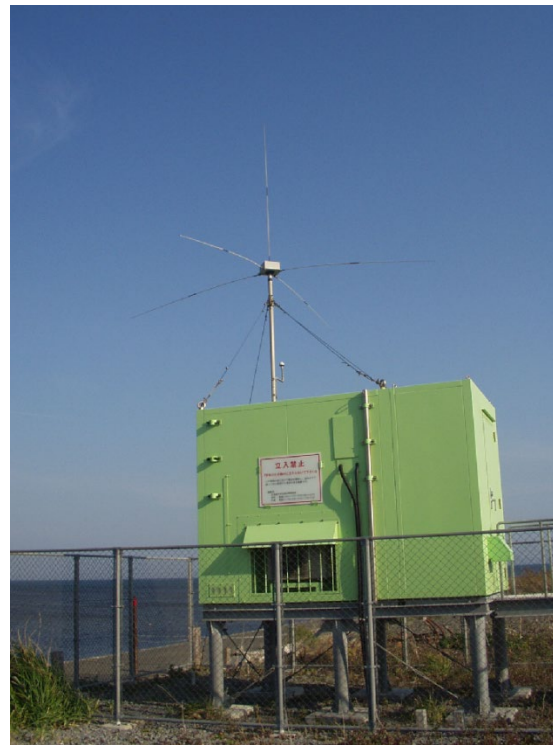
受信アンテナとシェルター
