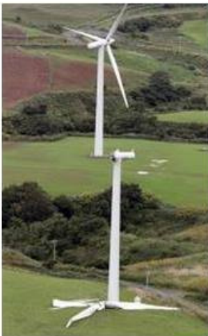
取り付け部分ごと羽根が落下した苫前グリーンヒルウインドパークの風車(6日、本社ヘリから)
